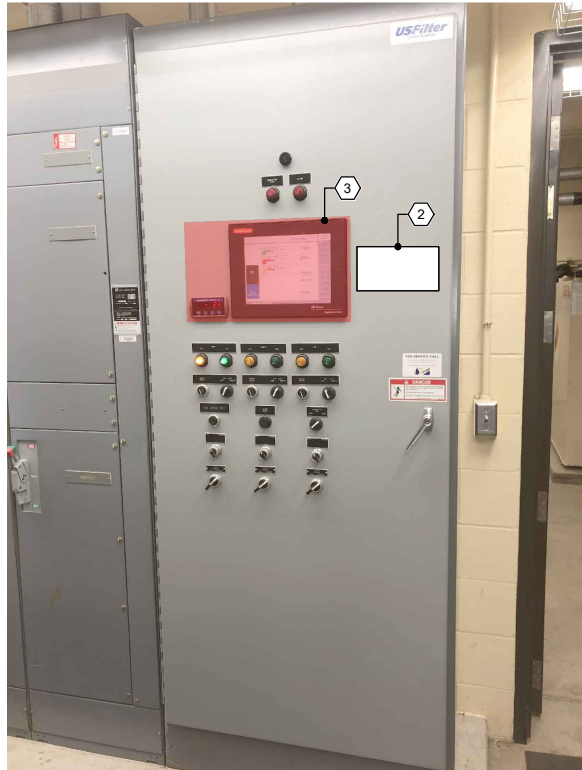
2 E104 L16 CONTROL PANEL FRONT DOOR
