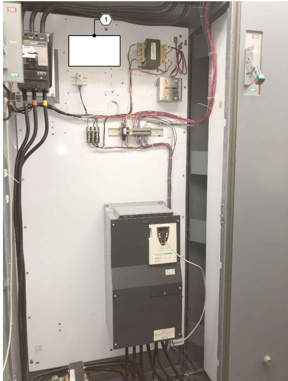
1 E104 VFD 3 PUMP MODULE INSTALLATION IMAGE
